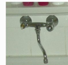
Mélangeur non adapté à un usage scolaire ... risque importante de fuite, brûlure, mauvaise fermeture ...
