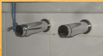
remplacement des mélangeurs par des robinets temporisés, à déclenchement souple
